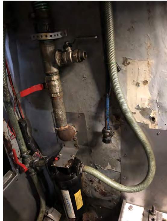
(b) Schottdurchführung Bb Seite mit angeschlossenen Armaturen
