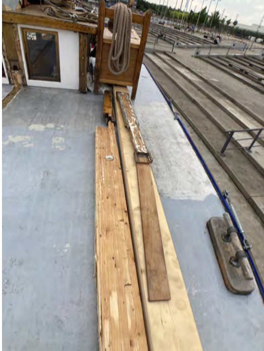
(a) Alter Tragbalken (links) und neuer Tragbalken (rechts) - ebenfalls sichtbar ist die Probebohrung (weißer Pfropfen), welcher nur knapp neben der schadhaften Stelle gemacht worden ist.
