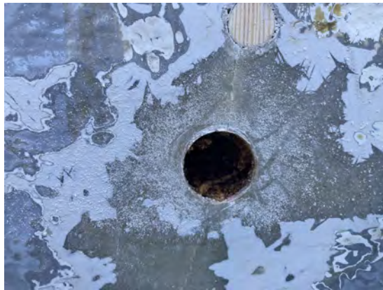
(a) Tragbalken Probebohrung genau im Riss, Foto ist von der Bb-Seite des Tragbalkens gemacht
