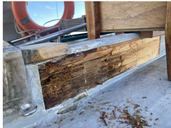
(b) Tragbalken entpackt, Schadensbild deutlich erkennbar, links ist die Mastfuß vom Besanmast sichtbar
