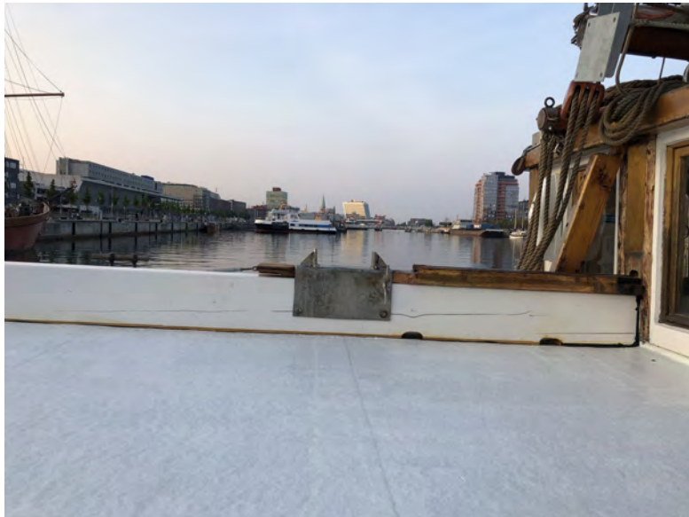
(b) Tragbalken fertig eingebaut, mit Speigatten für Wasserdurchlass - das Achterdeck hat hinter dem Ruderhaus die tiefste Stelle
