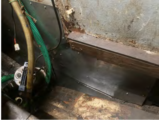
(a) Blechplatte, Blick von Stb
